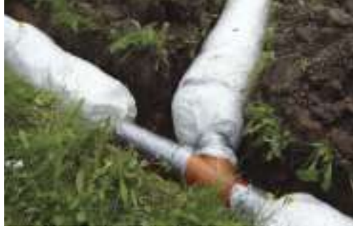
Banliyö drenaj borusu
